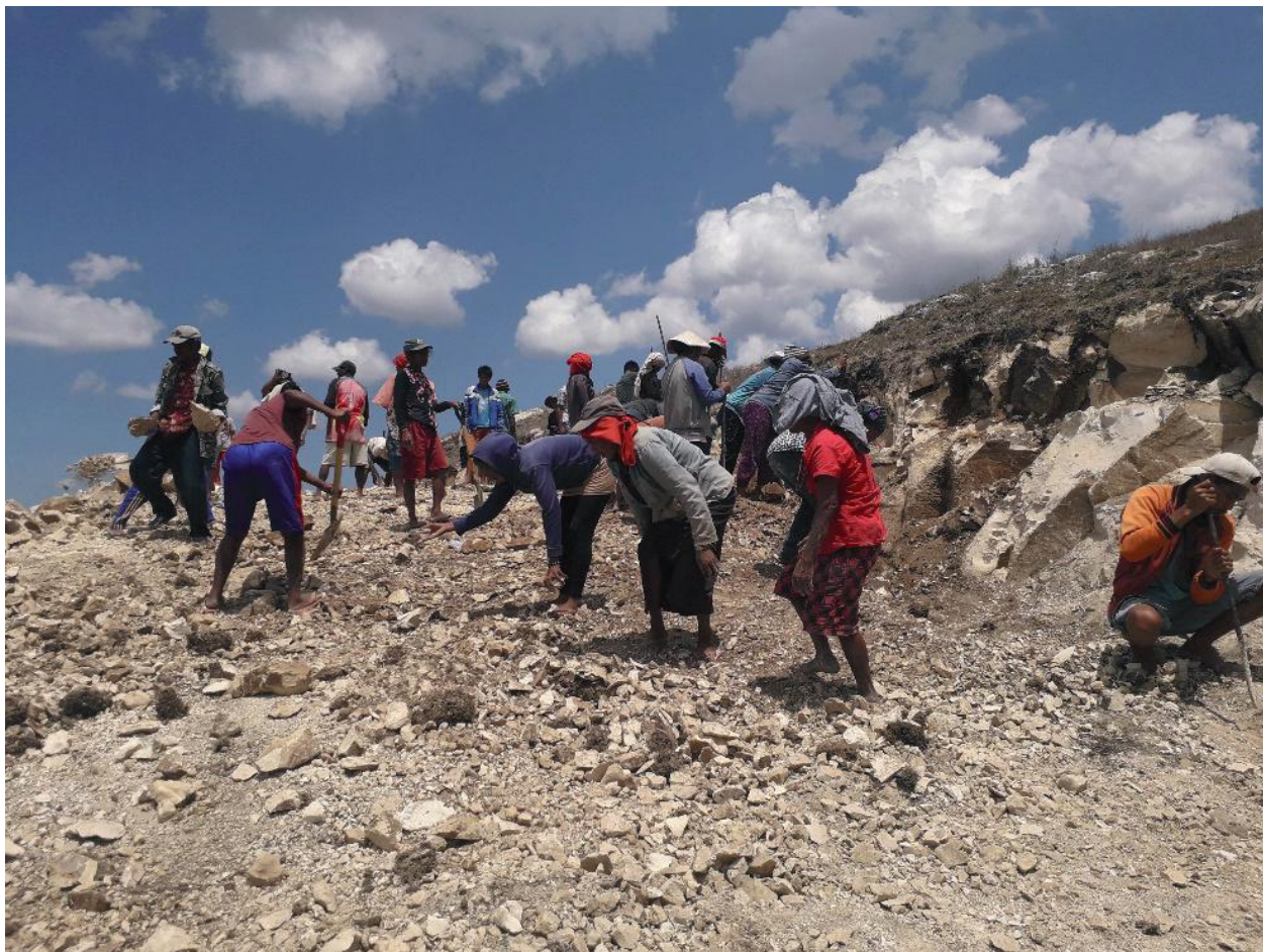
Gambar 7. Para Peserta PKTD, baik perempuan maupun laki-laki, dalam pembangunan jalan desa di Desa Mandahu, Kecamatan Katala Hamu Lingu, Kabupaten Sumba Timur
